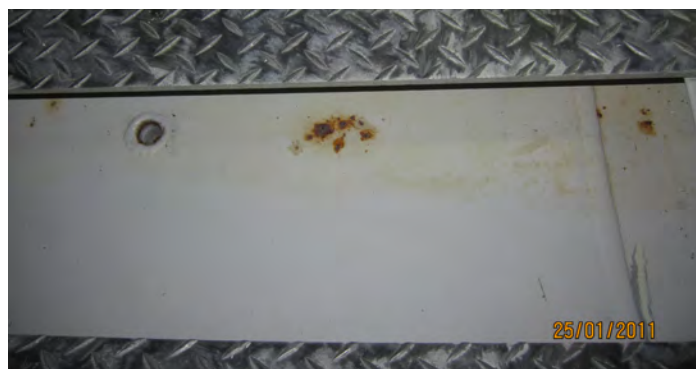
Puntos de corrosión reparables en la sentina
